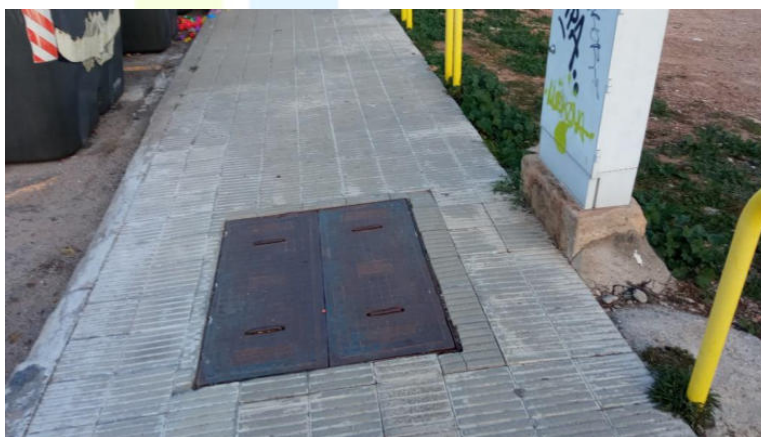
Detall arqueta telefònica Carrer dels Ocells
